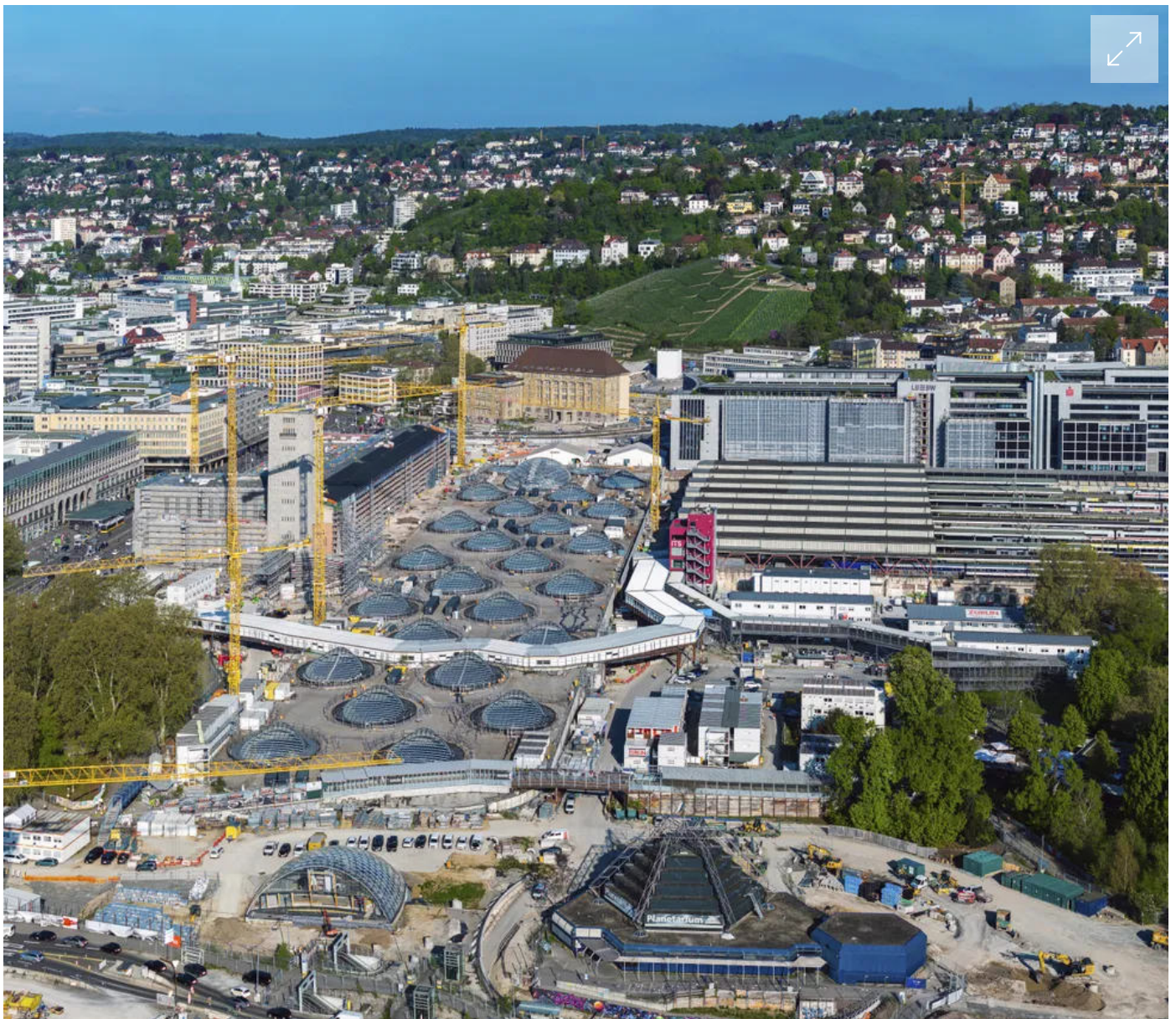
Tiefergelegt: Baustelle des neuen Stuttgarter Hauptbahnhofs Foto: Arnulf Hettrich / imageBROKER / Ullstein Bild
