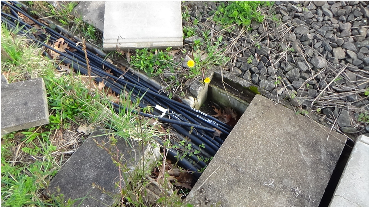
Signalleitungen am Bahnhof Waiblingen
